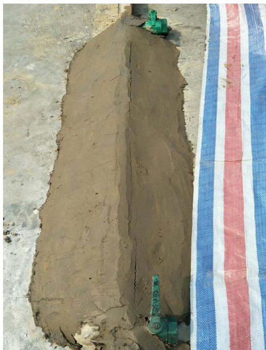
围堰初期雨水阀及后期雨水阀
