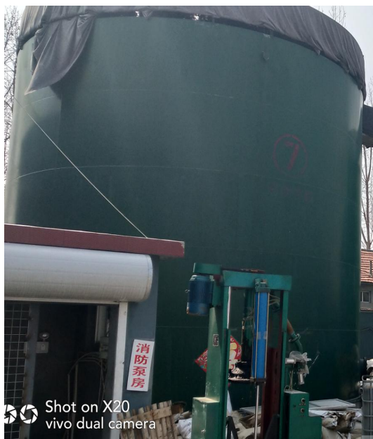
项目消防水罐
