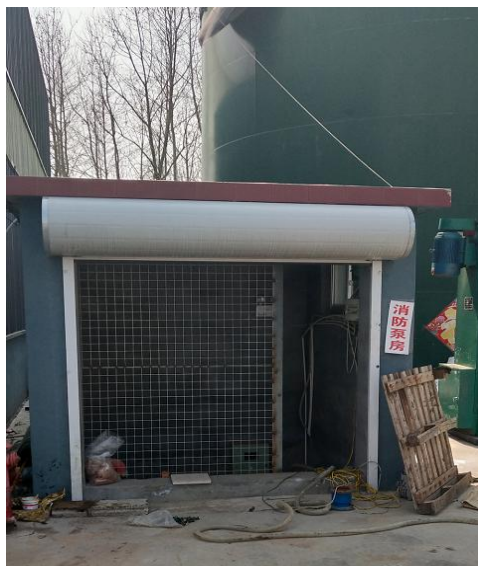
项目消防泵房
