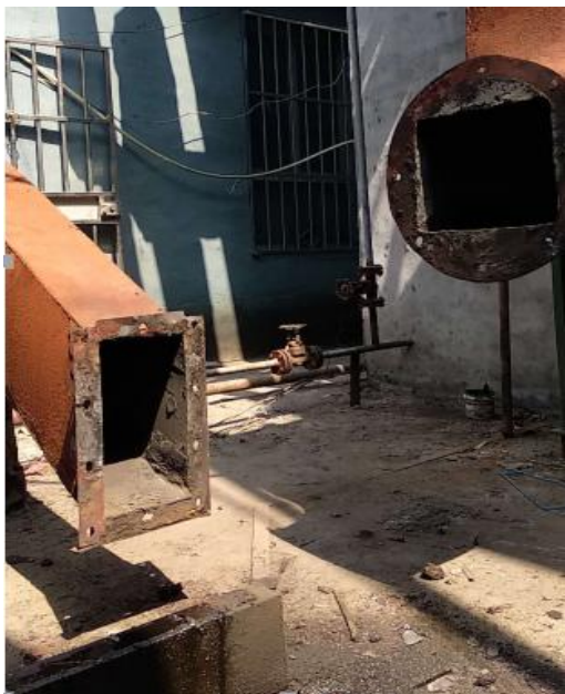
燃煤锅炉排气筒断开照片
